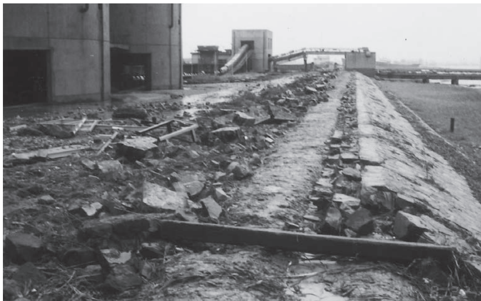
被台风冲倒的江堤、围墙
